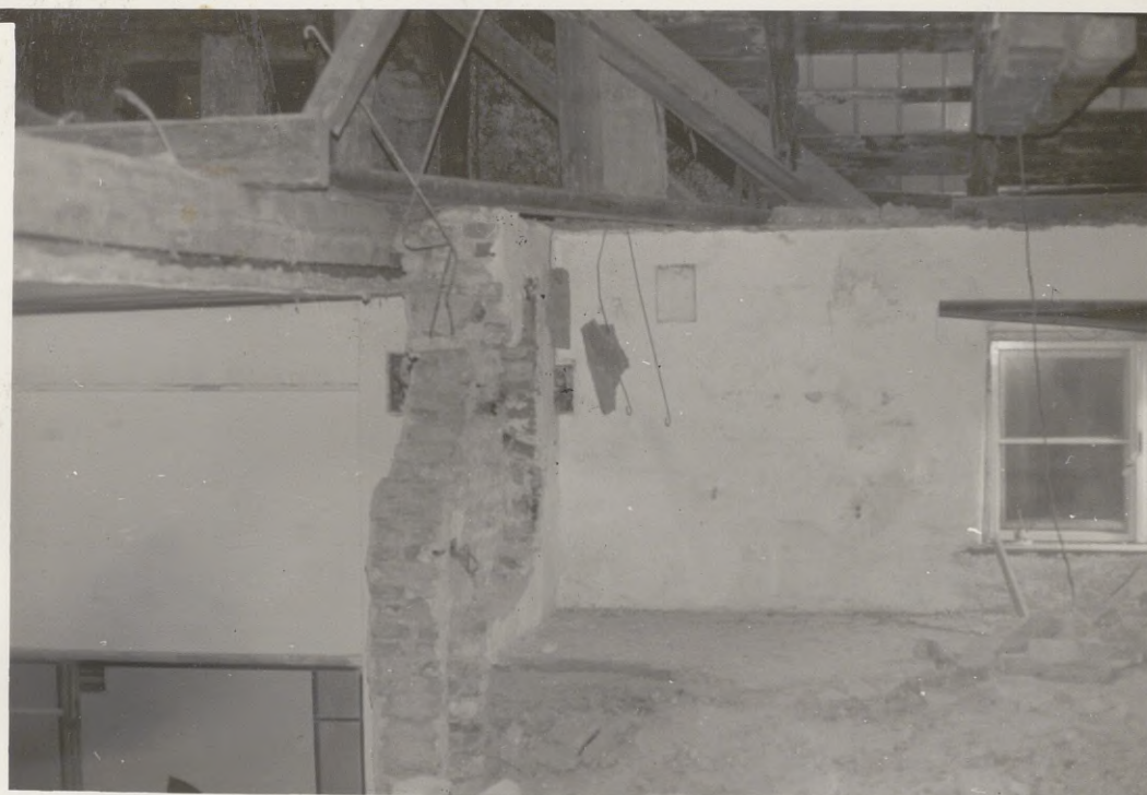
Tato přička musí pryč. Trámy stropu jsou obnaženy
